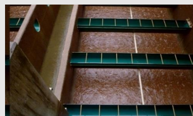
急速ろ過池(逆洗中)
