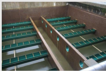
急速ろ過池(逆洗前)
