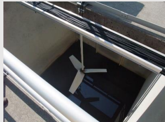
フロキュレーター(抜水中)
