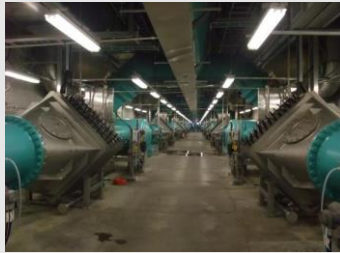
紫外線処理設備
