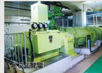
水位差発電設備
