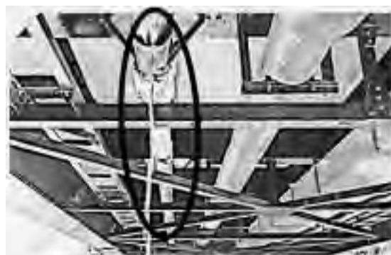
図5 赤外線カメラによる漏水箇所の撮影写真②*
