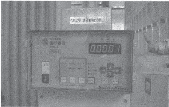
▲膜ろ過後の濁度…0.0001度
