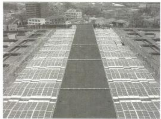
図 ろ過池覆蓋設置例(東京都水道局朝霞浄水場)
