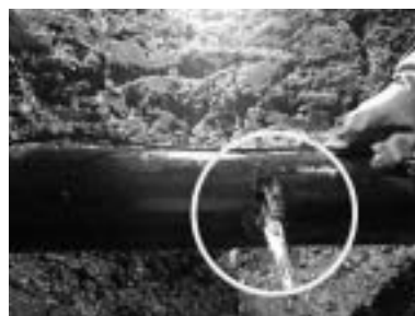
写真2 孔食による漏水
