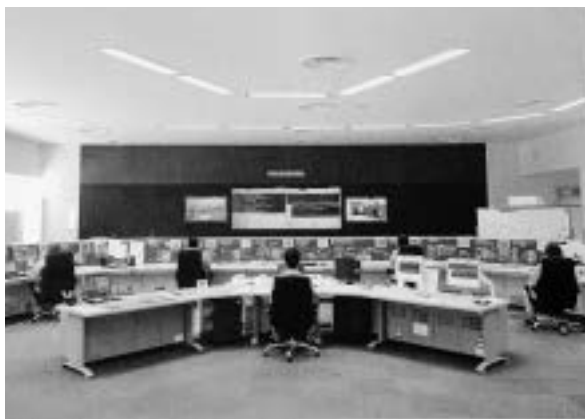
図1 送水管理センター 遠隔監視操作室
