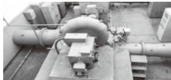
郡家ポンプ場 受水圧力発電設備
