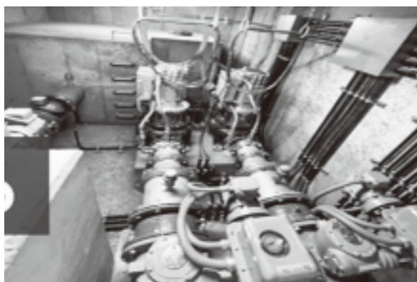
和泉浄水池 小水力発電設備
