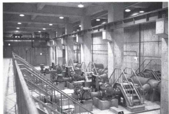
▲ポンプ室内部
