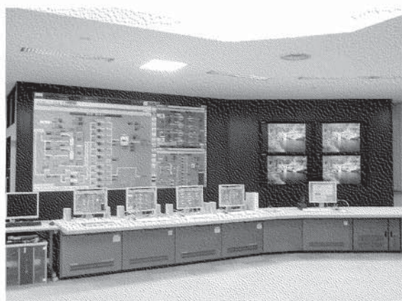
写真3 新石川中央監視室
