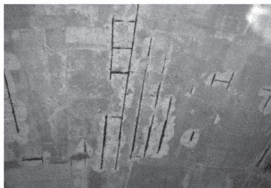
写真2 配水池天井部劣化状況
