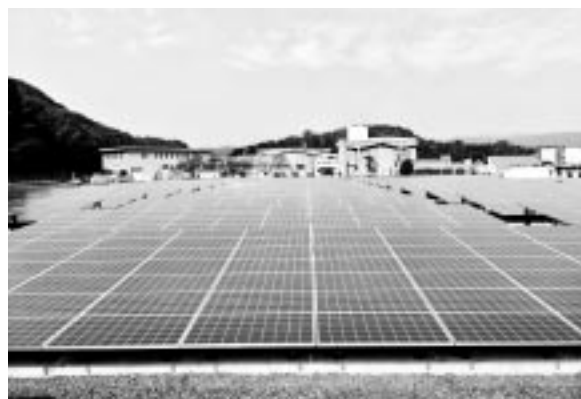
写真4 完成後の太陽光発電設備
