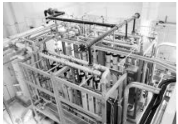
写真2 箱根施設（品ノ木浄水場）
