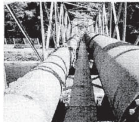
写真 神戸市水道局殿の水道橋(リベット鋼管) 大正6年架設、今も健在
