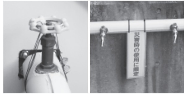
写真 蛇口の封印及び限定使用のプレート
