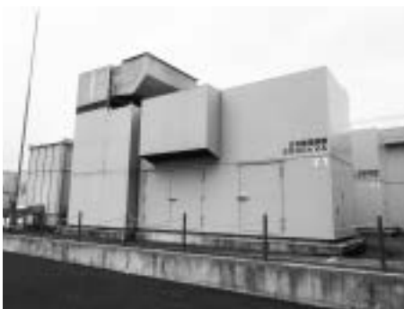
図1 自家発電設備（屋外型）
