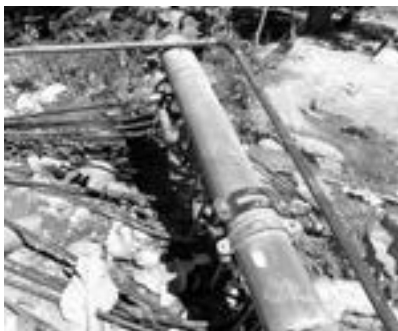
写真1 給水管の違法接続（盗水状況）
