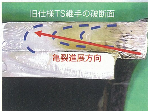
写真3 塩化ビニル管の亀裂部分の断面図
