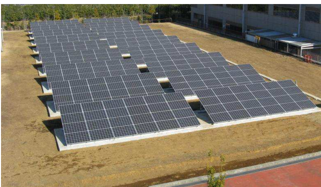
写真 配水池上部への太陽光パネル設置例
