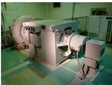
ます漕発電所(520kW)
