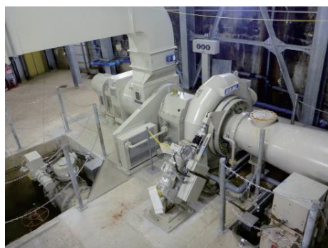
油木発電所(780kW)
