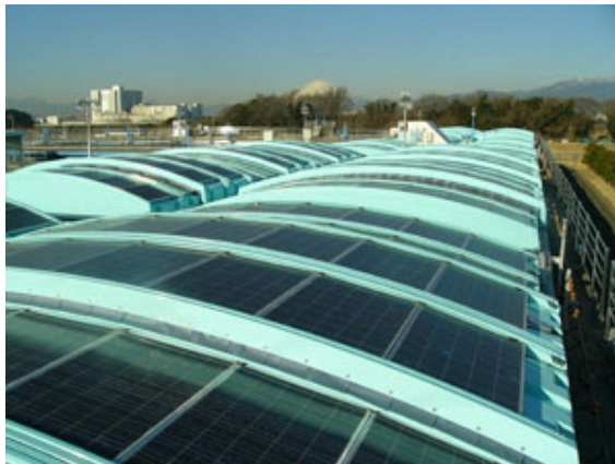
浄水場屋根の太陽光発電パネル
