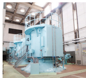
上井草給水所の 配水ポンプ
