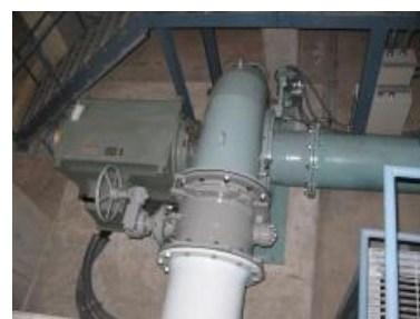
幕張給水場の水力発電設備
