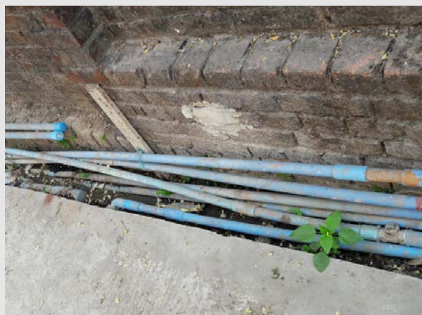
←現地の水道管の様子 （乱立するスパゲティ配管）
